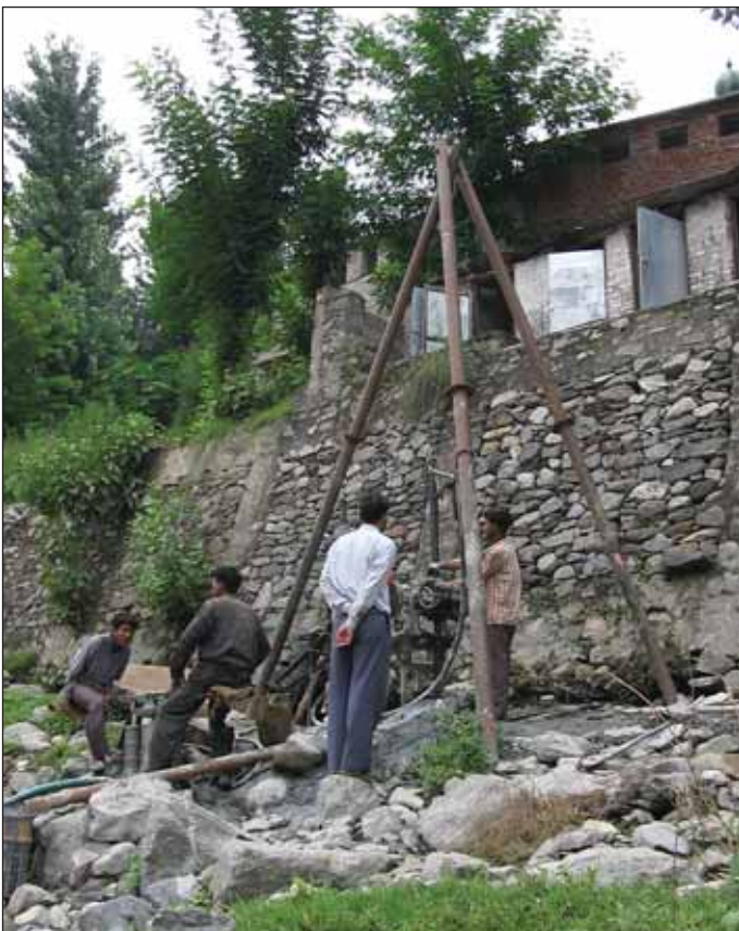
Obr. 3 Vrtání průzkumného vrtu u města Ramban Fig. 3 Exploratory borehole drilling by the Ramban town
