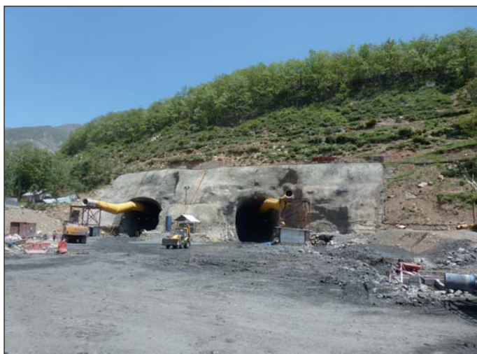
Obr. 6 Jižní portál tunelu Pir Panjal Fig. 6 South portal of Pir Panjal Road Tunnel
