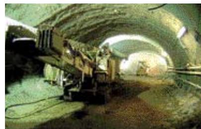
Obr. 7 – Propojka do šachty T5D
