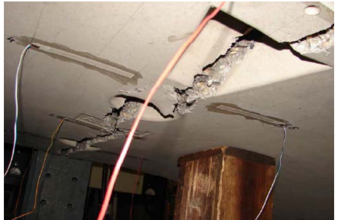
Obrázek 4. Segment zatížený ohybem kolmým na rovinu segmentu po porušení (pohled zespoda)
