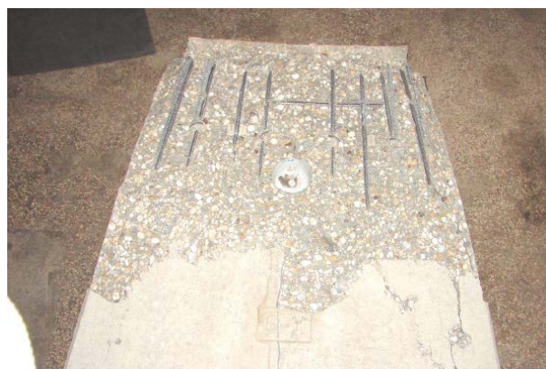
Obrázek 8. Delaminace železobetonových segmentů zatížených prostým tlakem
