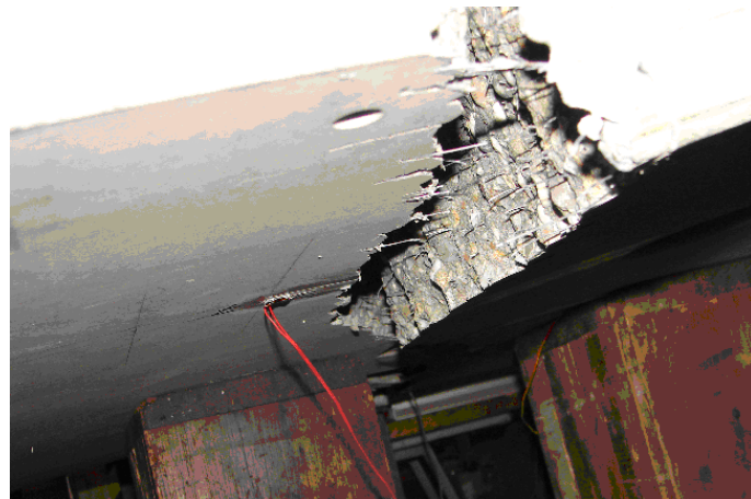
Obrázek 5. Vytržení drátků z betonu při úplném porušení
