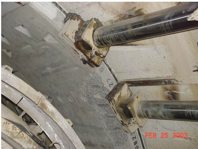
Obrázek 6. Odlamování hran železobetonových segmentů při zatížení lisy štítu (Herka & Schepers 2012)
