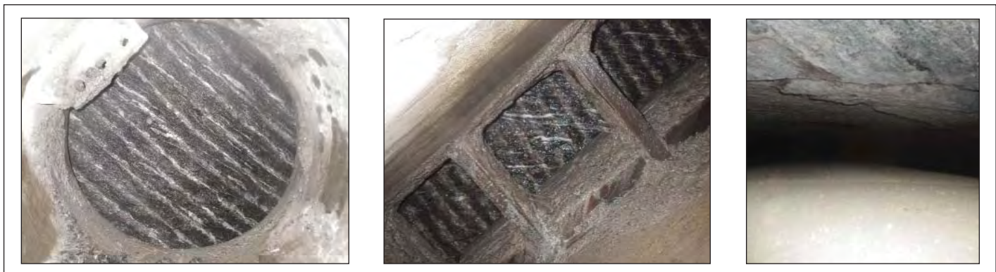
Obr. 6 Fotografická dokumentace čelby skrze otvory v řezné hlavě, tj. "Mannloch", otvory začišťovacích dlát, a dále mezery mezi segmentovým prstencem a horninou v klenbě
