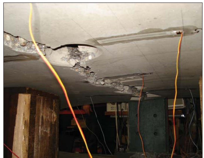
Obr. 4 Segment zatížený ohybem kolmým na rovinu segmentu po porušení (pohled zespoda)
