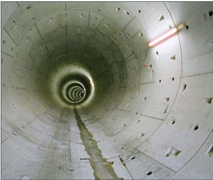
Obr. 16 Segmentové ostění tratového tunelu trasy A pražského metra Fig. 16 Segmental lining of a running tunnel on the Line A of Prague metro
