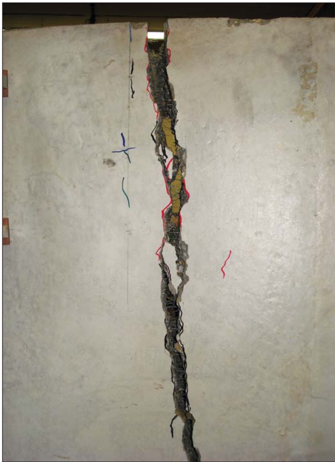
Obr. 13 a 14 Porušení drátkobetonového segmentu zatíženého ohybem v rovině segmentu
