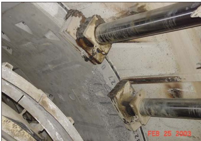
Obr. 6 Odlamování hran železobetonových segmentů při zatížení lisy štítu (Herka, Schepers 2012)
