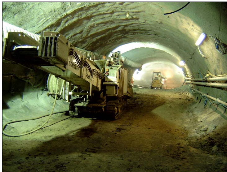
Obr. 5. Stříkané ostění z vláknobetonu realizované metodou LaserShell TM Fig. 5. Sprayed SFRC lining constructed by the method LaserShell TM
