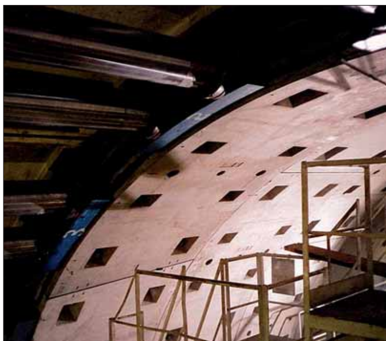
Obr. 4 Instalace segmentů v horní části ostění Fig. 4 Segment assembling in the roof area
